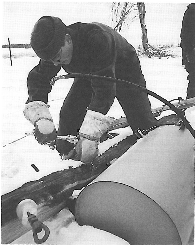
Dans la région de Farnham, les Voltigeurs aidèrent Hydro-Québec et la Detroit Edison à rétablir le courant. Ici, le caporal-chef S. P. Fréchette à l'ouvrage.
